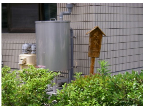
雨水タンク (西3号館)
